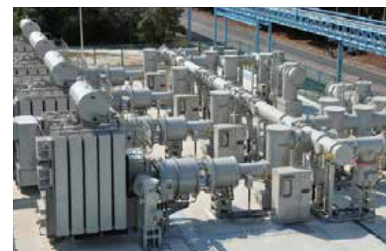
変電システム
