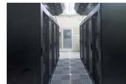
データセンター
