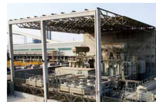
大容量整流設備
