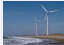
風力発電システム
