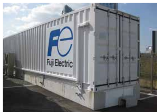
蓄電システム
