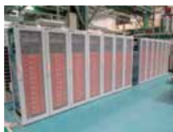
蓄電池システム
